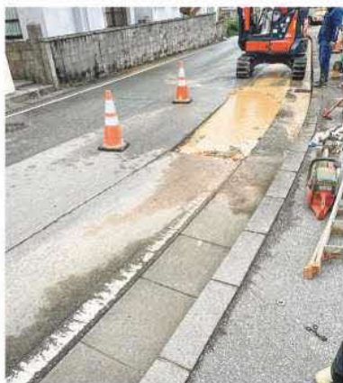
▲水道管の現状
