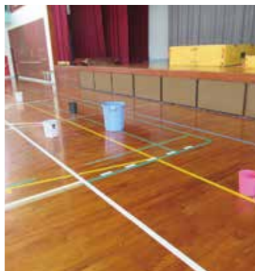
仲泊校体育館の雨もり状況
