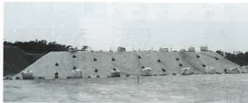
恩納第一地区汚水処理施設建設予定地。また恩納第一地区管路工事も、継続事業として行われ環境にやさしい施設として、早期の供用開始が望まれます。
