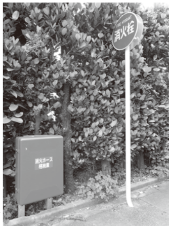
恩納区に設置されている簡易消火栓
