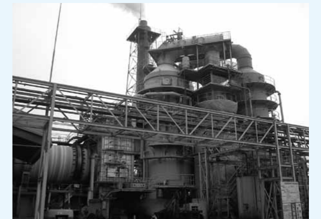
有毒ガスの無害化装置
