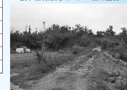
真栄田配水池造成 (富里原)
