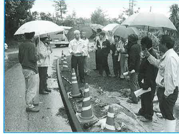
村道26号前兼久上原線改良工事 総延長は、約776mで今回の工事予定は、200mです。
