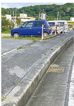
▲老朽化したガードパイプと車が落ちたことでキズのついた縁石
