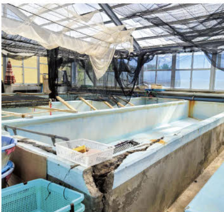
▲破損した水槽
