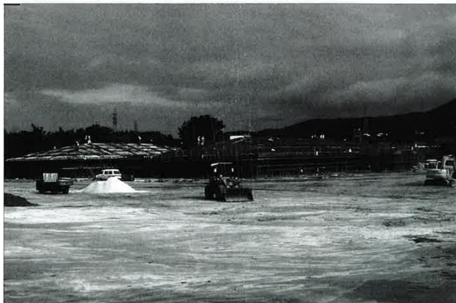
▲完成に向けて々と工事が進められている村保健福祉センター
