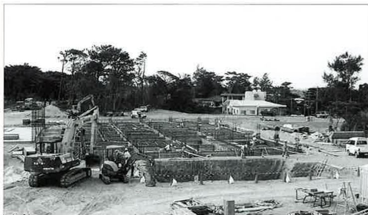
▲完成に向けて着々と工事が進められている村総合保健福祉センター
