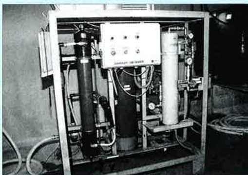
▲恩納漁港内の設置された濃縮分離装置
